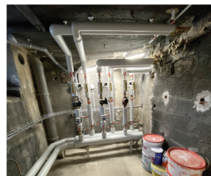
Équipement électro-ménagers modernes et au sous-sol un système de chauffage-chaudière économique
